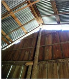
Fig. 9a. Gap at ridge.
